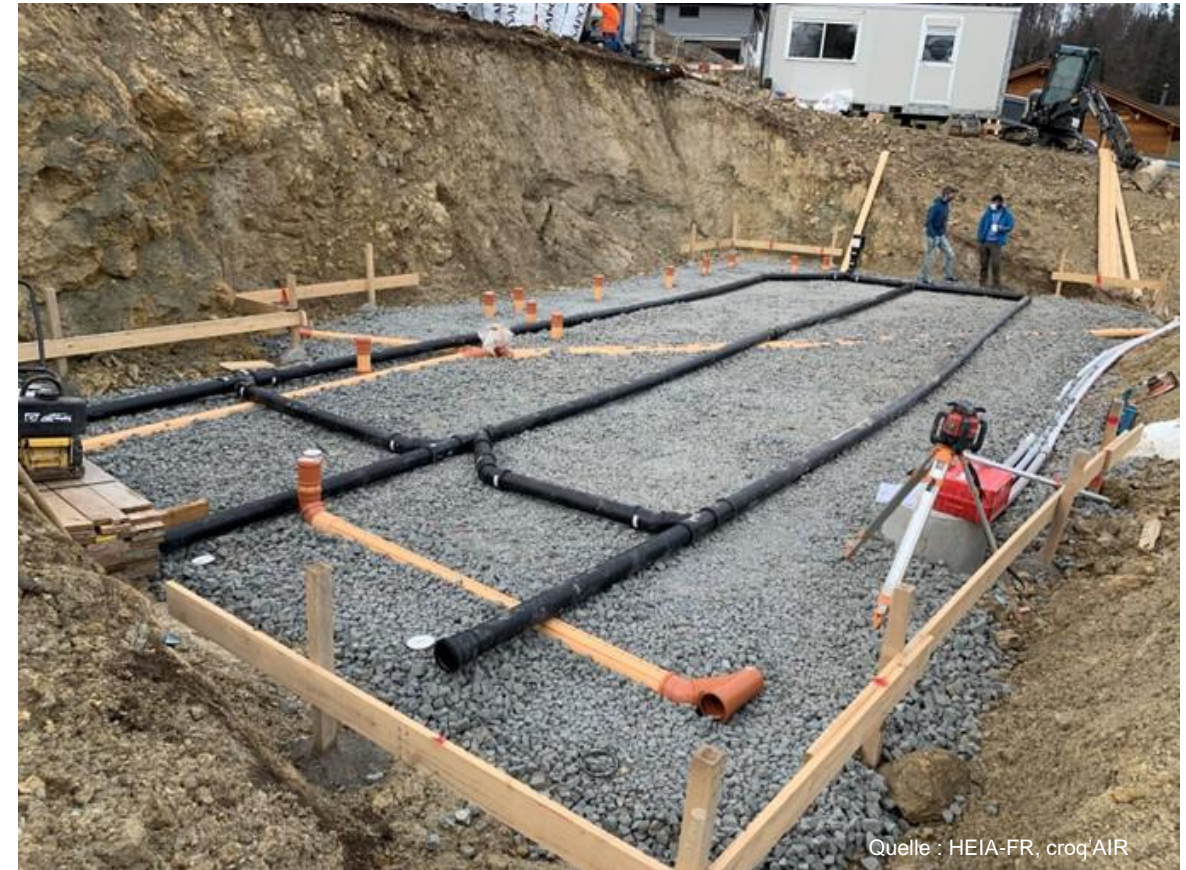
Foto der Radondrainage
